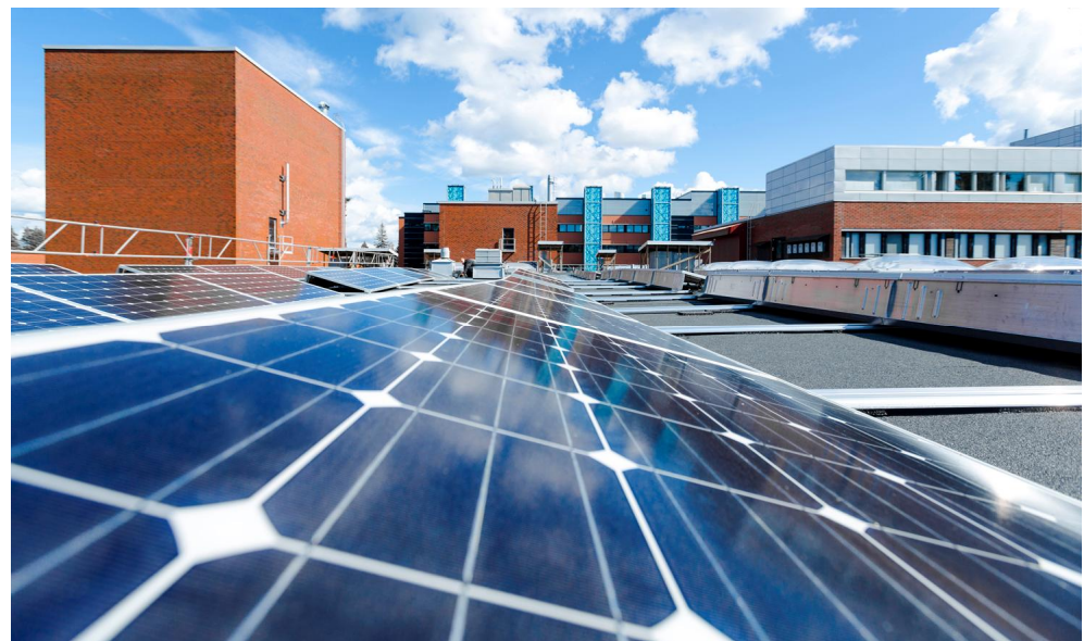
Kuva 2. Aurinkopaneeleita Lappeenrannan teknillisen yliopiston katolla. (Kuva: © Teemu Leinonen)
